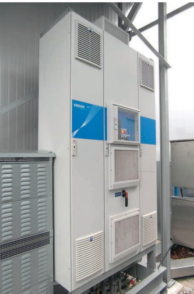
De VACON® NXC Active Front End van Danfoss zet de hoge frequentie uit de generator van de SteamExpander om in 50 Hz voor het elektriciteitsnet (foto: Ad Spijkers)
