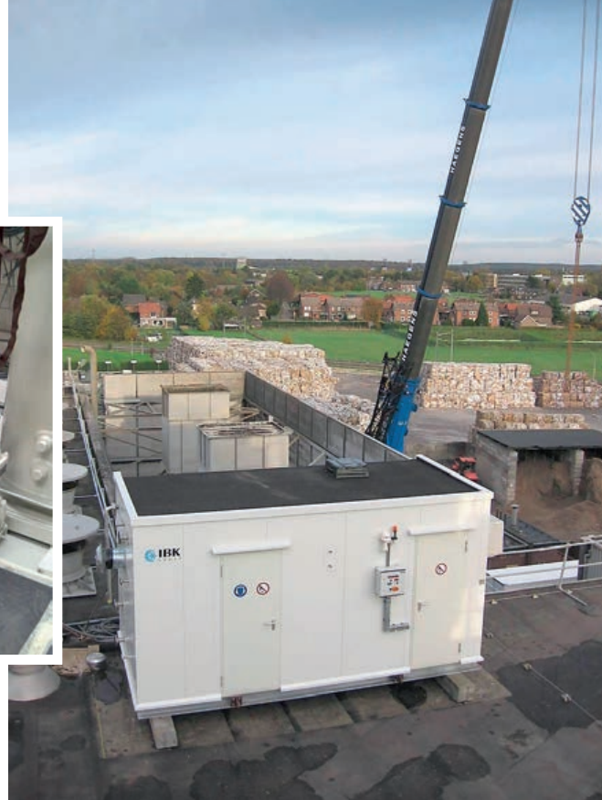
Foto rechts: de warmtepomp op het dak bij Smurfit Kappa Papier Roermond
